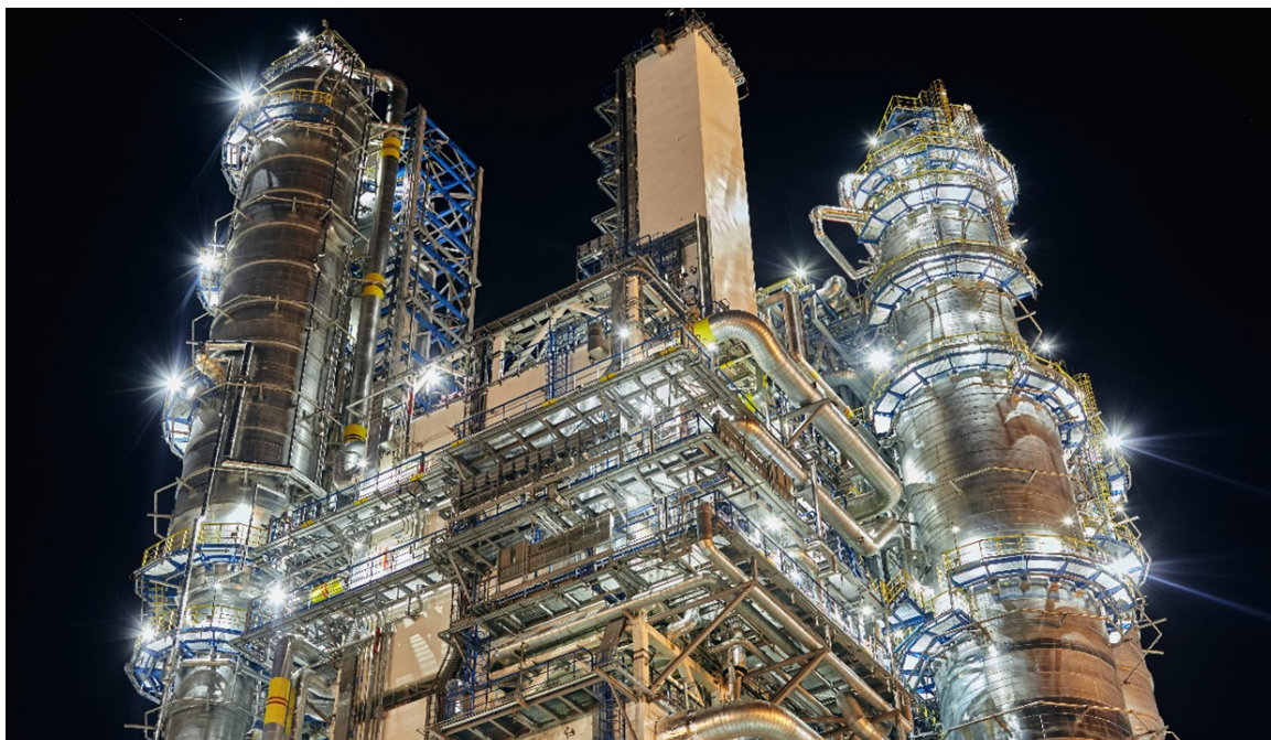
Рис. 5. Колонны для очистки газа на Амурском ГПЗ. Фото С.Р. Овчарова.
