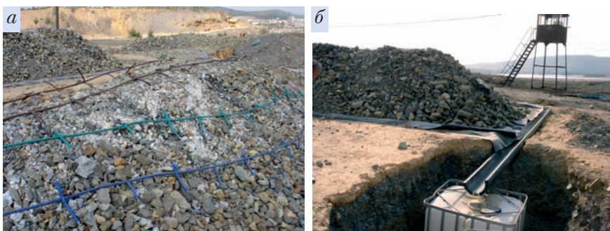
Рис. 3. Элементы оросительной системы (а) и системы дренажа и сбора продуктивных растворов (б)
