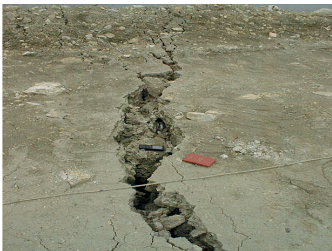
Рис. 3 Морозобойная трещина на выровненной приводораздельной поверхности. Фото С.И.Серикова.
